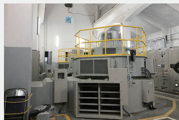
発電設備(第二発電所)
