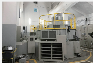
発電設備（第二発電所）
