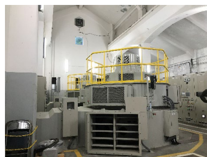
発電設備(第二発電所)
