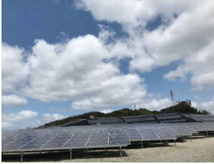
古賀ソーラーパークⅡ（福岡県糟屋郡新宮町）
