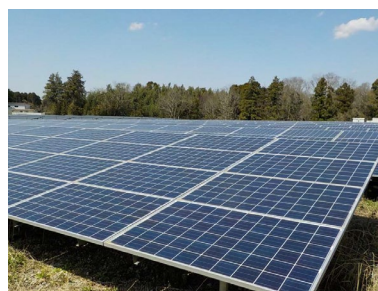
若葉区富田町太陽光発電所
